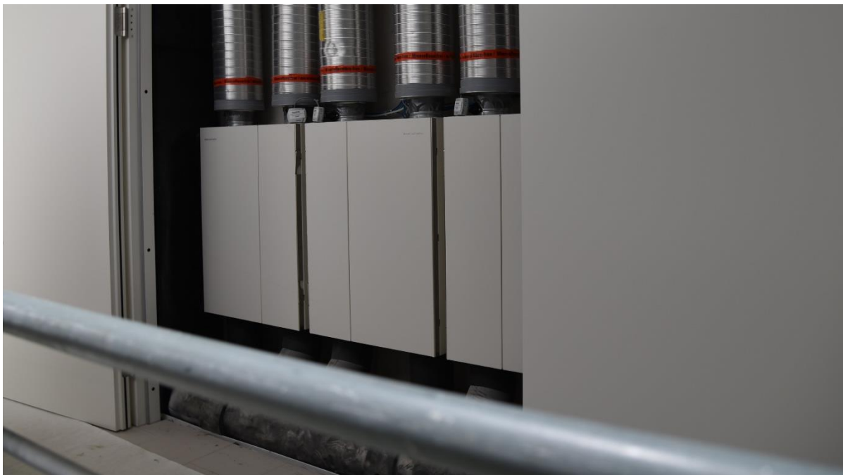
Abbildung 12: Dezentrale wohnungsweise Komfortlüftungsanlagen vom Treppenhaus aus zugänglich (Foto: Energieinstitut Vorarlberg).
