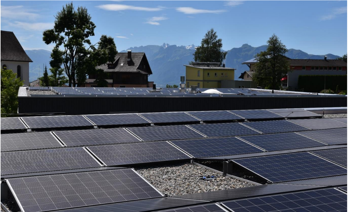
Abbildung 19: PV-Anlagen mit jeweils 30 kWp auf beiden Gebäuden in Dafins (Quelle: Energieinstitut Vorarlberg).
