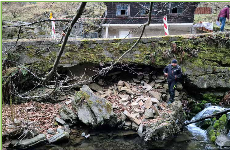
Abbildung 29: Starke Regenfälle haben die Straße beschädigt und auch das Haus ist stark gefährdet.
