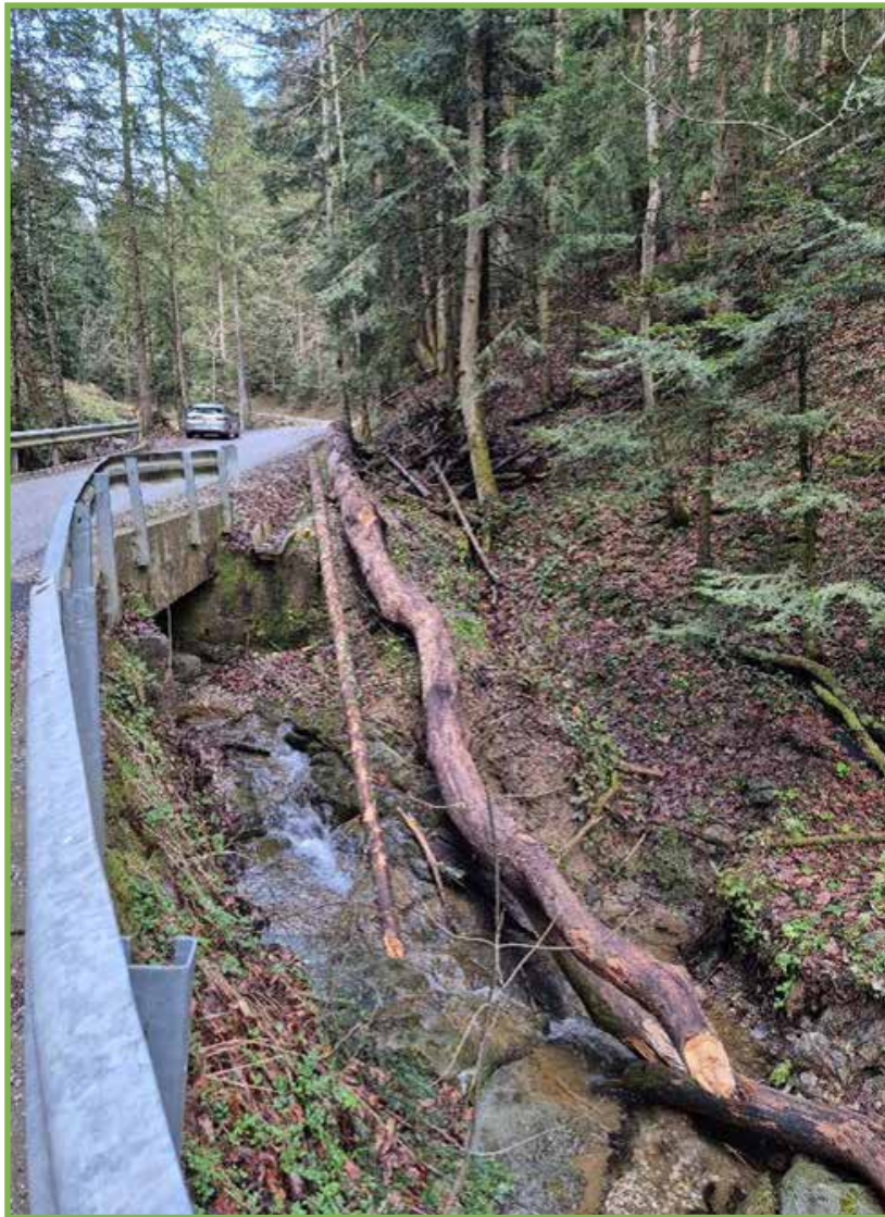
Abbildung 30: Falsche Waldbewirtschaftung und Rückstände in den Bächen sind ein echtes Ärgernis für die Straße.
