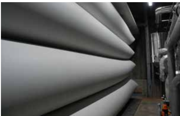
Auch die Faulgase der Klärschlämme werden zur Energieerzeugung im Blockheizkraftwerk genutzt. Gasspeicher mit insgesamt 900 m 3 stehen bereit.
