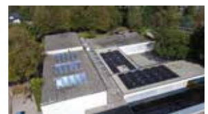
Kindergarten Brühl: 30 kWp
