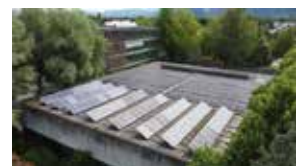
Öko-Mittelschule Turnhalle: 31 kWp
