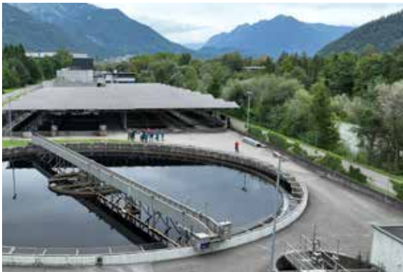
Mehrfacher Nutzen eines PV-Dachs: Eigens produzierter Solarstrom senkt die Energiekosten, die Beschattung belüftet und sorgt für geringere Temperaturschwankungen und Algenbildung.
