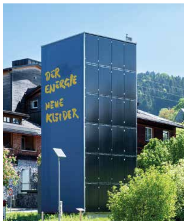
PV-Strom ist einer der wichtigsten erneuerbaren Energieträger in Langenegg, auch bei der Trafostation in Langenegg. (© Mario Nussbaumer)
