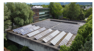
Öko-Mittelschule Turnhalle: 31 kWp
