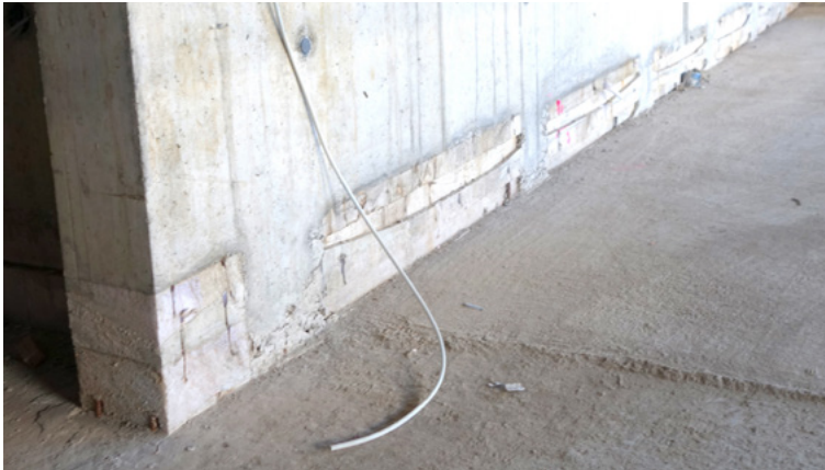
Abbildung 20: Zinnenlösung beim Anschluss der Innenwände auf die kalte Keller-/TG-Decke zur Minimierung der Wärmebrücke.
