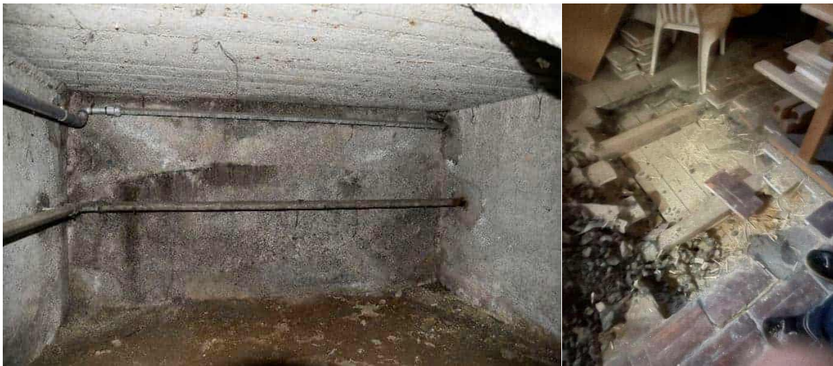
Abbildung 4: Zustand des Kellers im größeren Gebäude (links) und oberste Geschoßdecke im kleineren Gebäude; Fotos Rhomberg Bau GmbH
