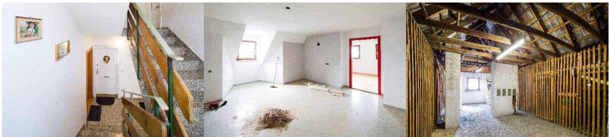
Abbildung 34: Gebäudetyp groß, Treppenhaus, Dachgeschoßwohnung und unbeheizter Teil des Dachgeschosses (Fotos: Walser Fotografie, Hohenems)
