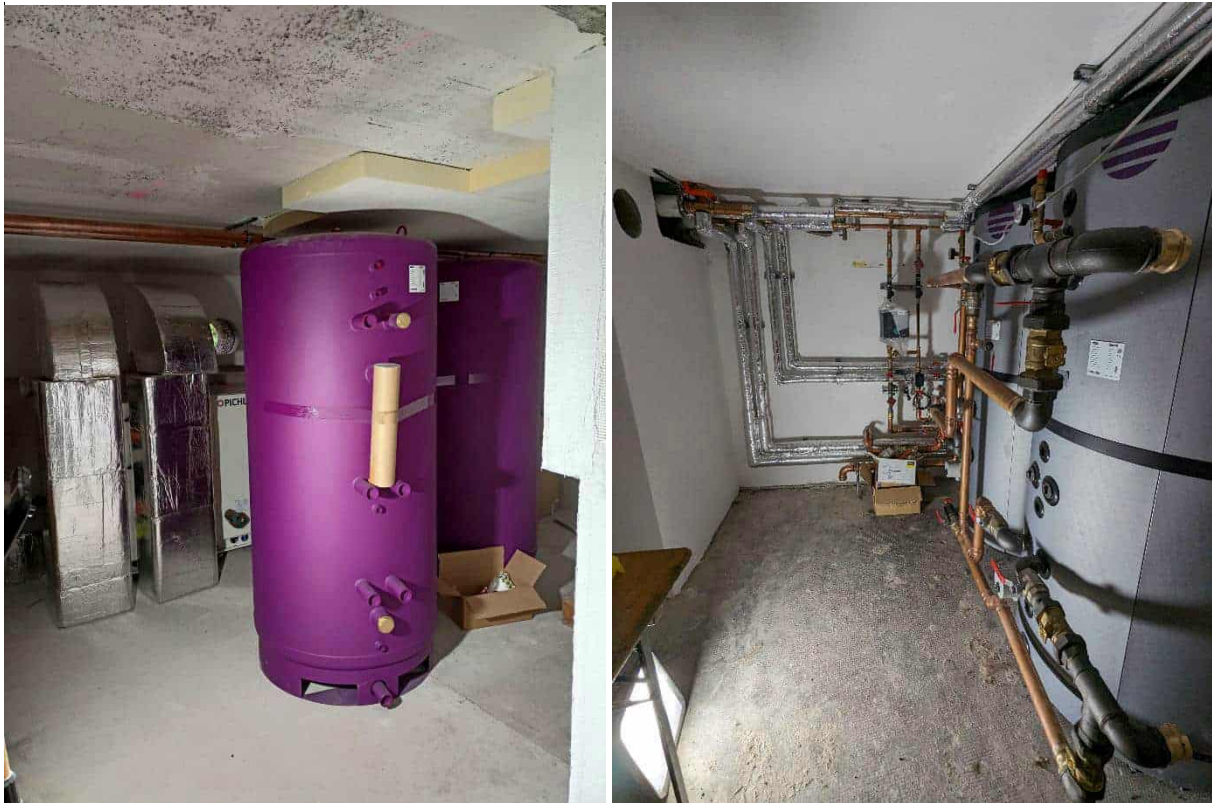
Abbildung 126: Schichtenspeicher ohne Dämmung und im eingebauten Zustand; Fotos: Rhomberg Bau GmbH (links), Johannes Kaufmann und Partner GmbH
