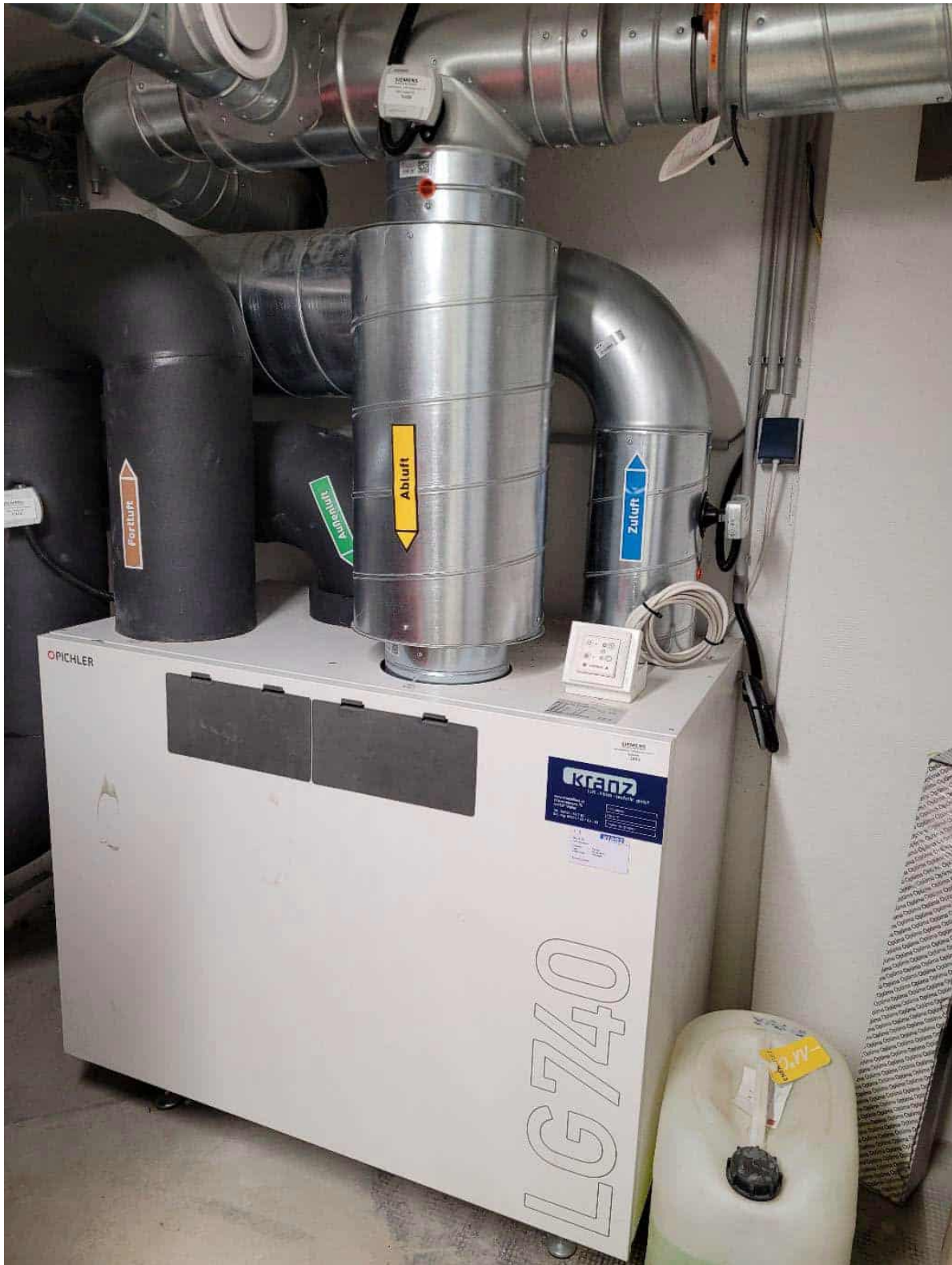
Abbildung 194: zentrales Komfortlüftungsgerät mit Wärmerückgewinnung im kleineren Gebäude; Energieinstitut Vorarlberg
