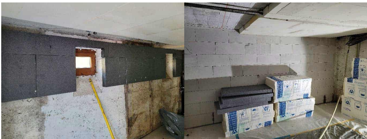
Abbildung 101: Flankendämmung im oberen Bereich der Außenwand KG; Dämmung der Kellerdecke, Fotos: Rhomberg Bau GmbH
