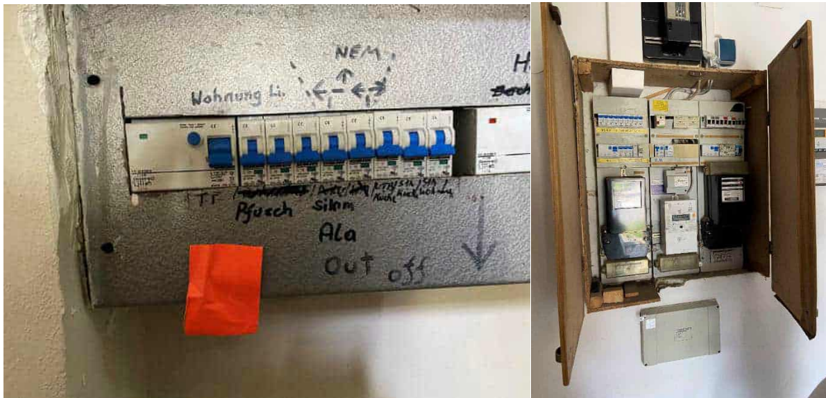
Abbildung 57: Impressionen vom Zustand der Elektroinstallation – Haus St. Antoniusstraße 34 – links und kleineres Mustergebäude (Fotos: Energieinstitut Vorarlberg, links und Rhomberg Bau GmbH, rechts)
