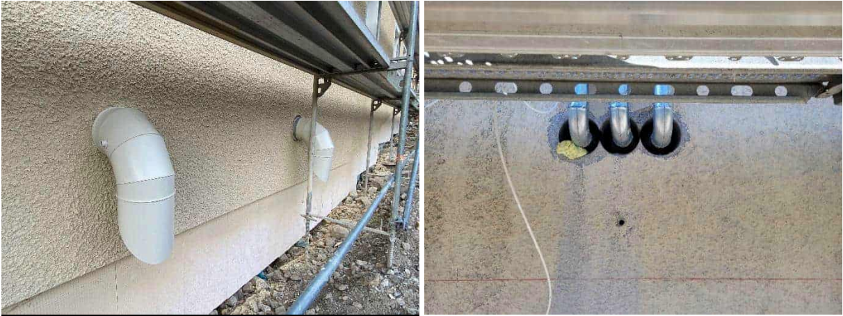
Abbildung 135: Außenluftansaugung und Fortluftausblasung im Sockelbereich; Wanddurchführungen der Zuluftrohre in Höhe Unterkante Kellerdecke; Fotos: Energieinstitut Vorarlberg
