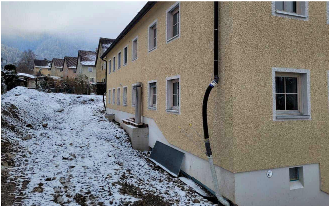
Abbildung 196: Außenluftansaugung an der Rückseite des Gebäudes; Energieinstitut Vorarlberg
