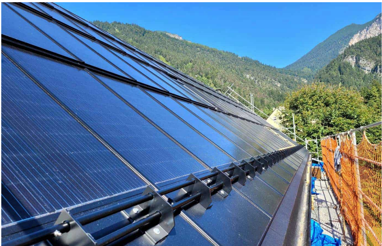
Abbildung 139: Indach-PV-Anlage im großen Gebäude; Foto: Energieinstitut Vorarlberg
