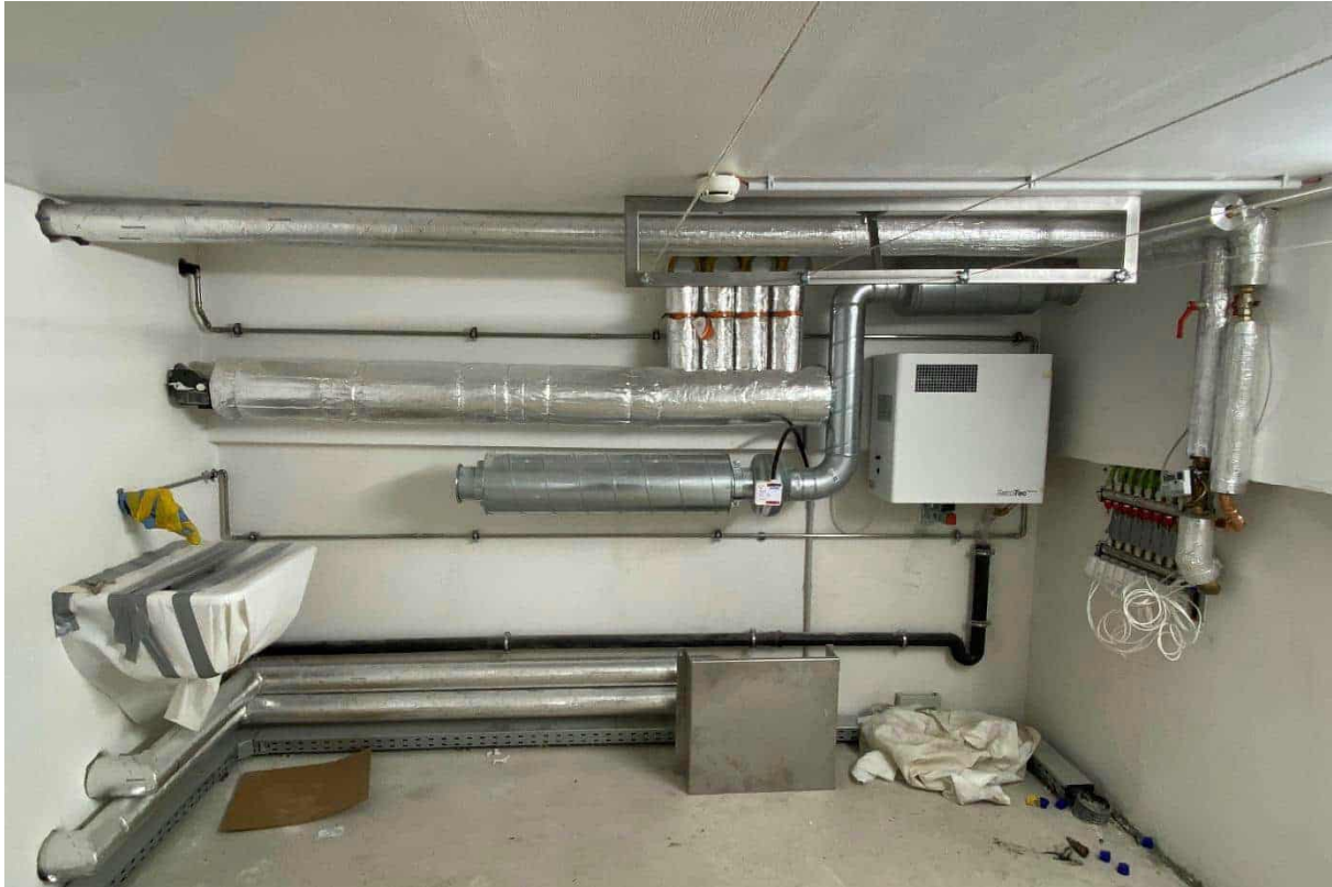
Abbildung 137: Abluftanlage und Raumentfeuchter im Trockenraum; Foto: Energieinstitut Vorarlberg
