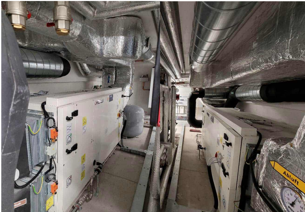
Abbildung 130: zentrales Komfortlüftungsgerät mit WRG im KG; Fotos: Energieinstitut Vorarlberg
