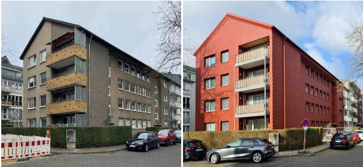
Abbildung 213: Serielle Sanierung Projekt 2426 in Köln vorher – nachher; Planung und Fotos: Zeller Kölmel Architekten, Köln
