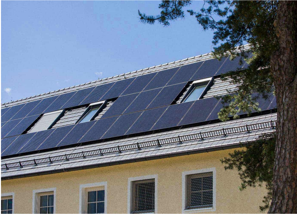
Abbildung 199: PV-Anlage kleines Gebäude; Fotos: Rhomberg Bau GmbH
