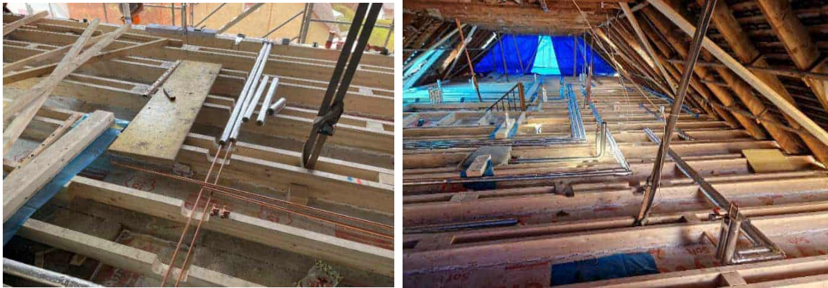
Abbildung 191: kleines Gebäude: Nutzung der obersten Geschoßdecke zur Horizontalverteilung, Fotos: Rhomberg Bau GmbH
