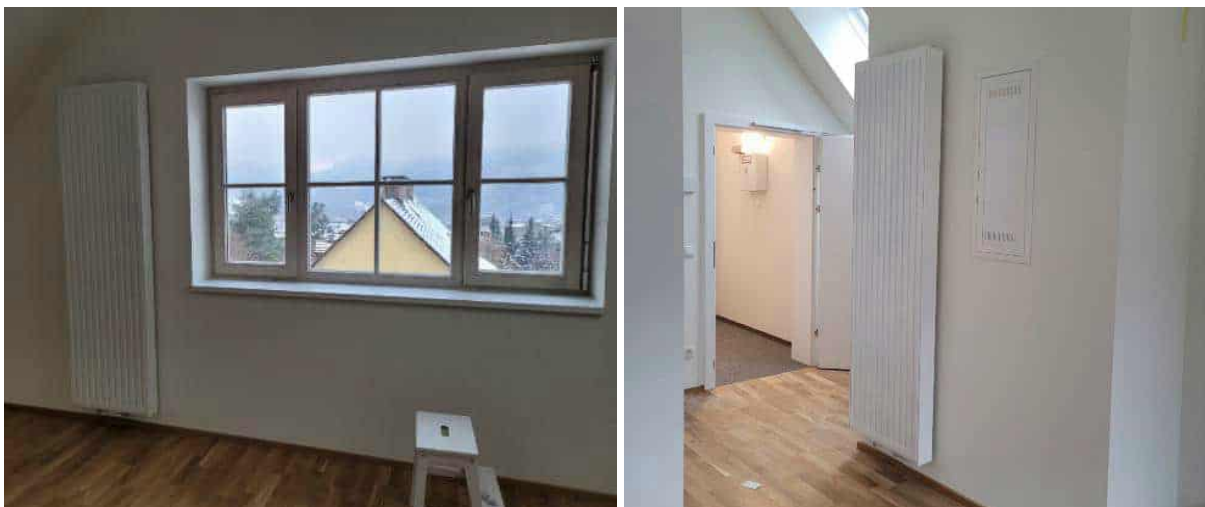
Abbildung 192: Niedertemperatur-Heizkörper im DG des kleinen Gebäudes; Energieinstitut Vorarlberg
