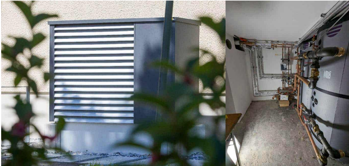
Abbildung 12: Luftwärmepumpe und Schichtspeicher großes Gebäude; Fotos: Walser Fotografie, Hohenems, links, Johannes Kaufmann und Partner GmbH, rechts
