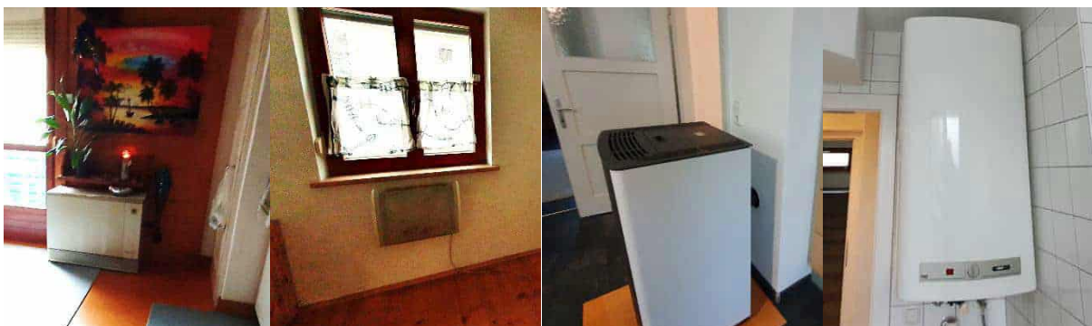
Abbildung 54: Beispiele der eingesetzten Heizsysteme sowie Elektro-Warmwasserboiler (Foto: Energieinstitut Vorarlberg)
