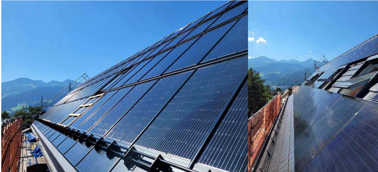
Abbildung 13: dachintegrierte PV-Anlage im größeren Gebäude und Aufdachanlage im kleineren Gebäude; Fotos: Energieinstitut Vorarlberg
