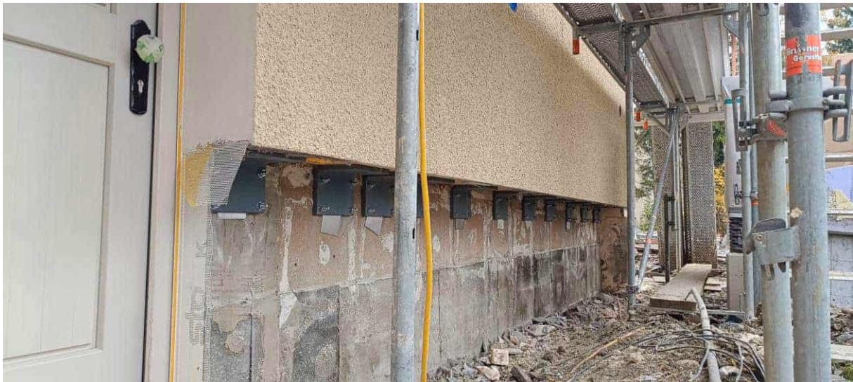
Abbildung 115: großes Gebäude: unterer Abschluss der Fassadenelemente mit Metallwinkeln als Auflager für die Schwelle; Foto: Rhomberg Bau GmbH
