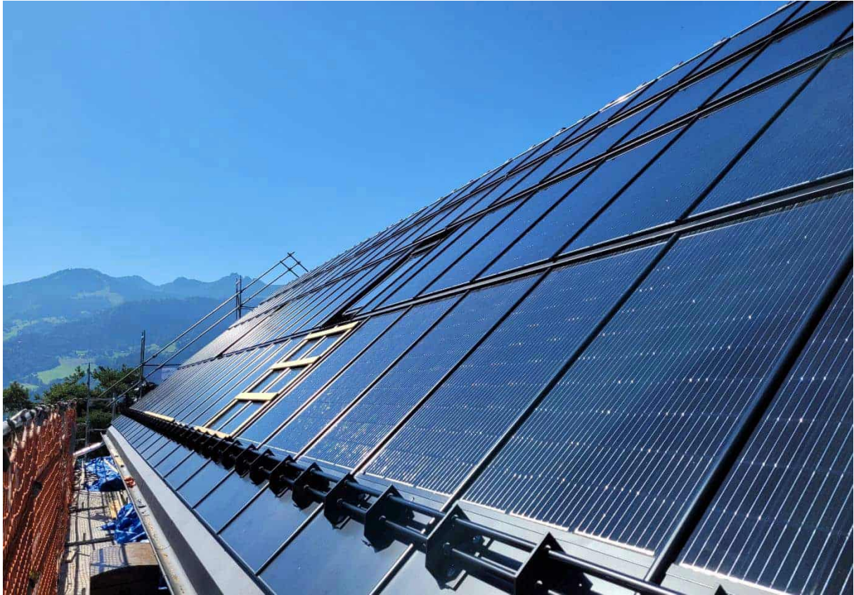
Abbildung 138: Indach-PV-Anlage im großen Gebäude; Foto: Energieinstitut Vorarlberg
