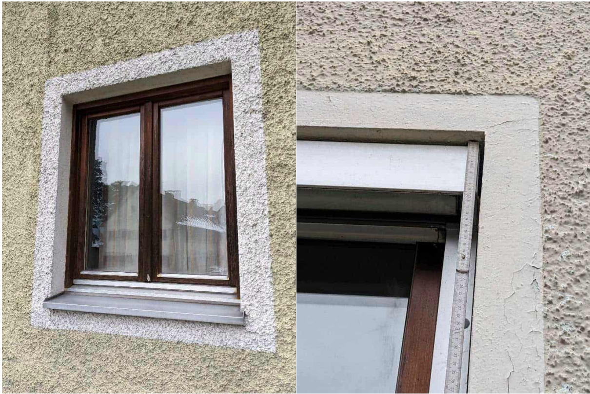
Abbildung 48: Fenster ohne außenliegenden Sonnenschutz im kleinen Gebäude – links, Foto: Energieinstitut Vorarlberg und mit Sonnenschutz im großen Gebäude, Foto: Rhomberg Bau GmbH
