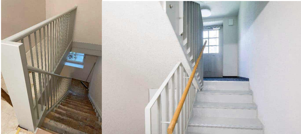
Abbildung 183: kleines Gebäude: Treppenhaus vor und nach Sanierung, Fotos: Rhomberg Bau GmbH (links); Walser Fotografie
